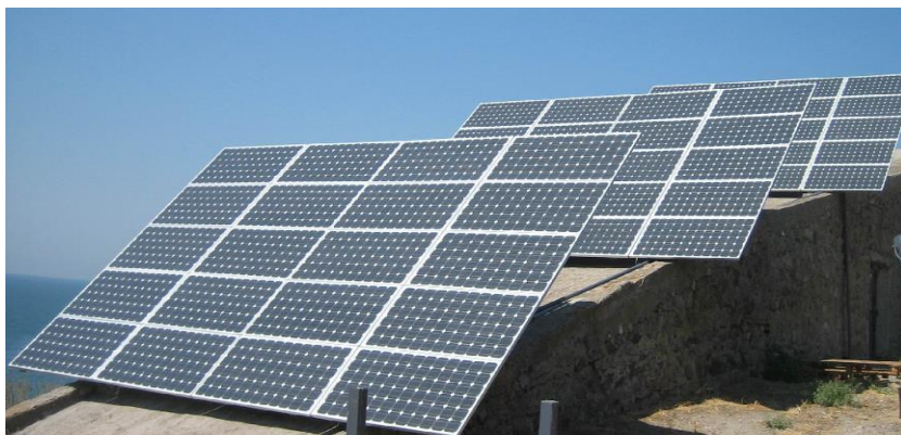
Рис. 3.9. Фотоелектрична станція потужністю 10 кВт на острові Зміїний
