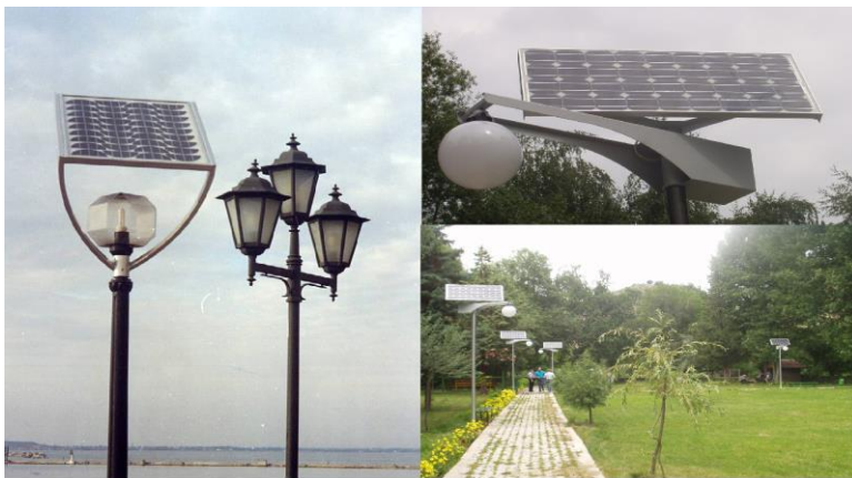
Рис. 3.8. Система фотоелектричного освітлення ботанічного саду в м. Києві
