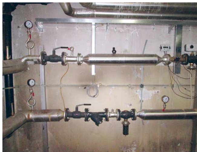
Тепловий пункт «Ципелісі» після реконструкції
