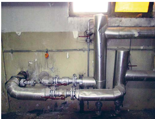
Тепловий пункт «Ципелісі» до реконструкції
