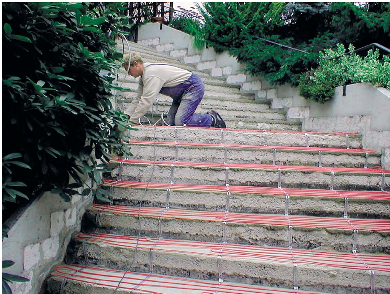
Система сніготанення на сходах
